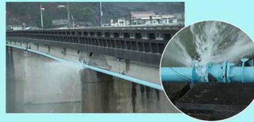
沼田東町本市橋 鋼管φ150 継手離脱
