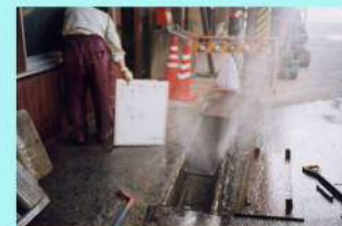
宮沖三丁目 φ13 耗鋼管 給水管破損
