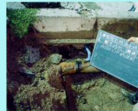
铸铁管φ150 耗洞折れ破損 糸崎町県道糸崎港線
