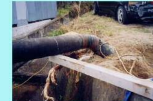
沼田東町釜山 鋼管φ200 耗継手（溶接箇所）破損
