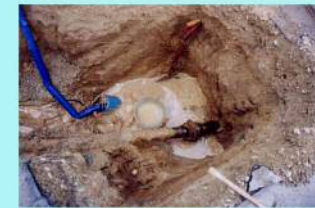
沼田西町 φ75 耗铸铁管 継手離脱
