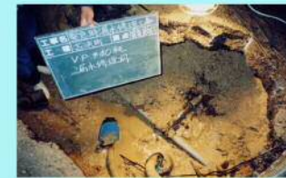
古浜町 φ40 耗ビニール管 給水管破損
