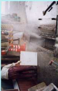
宮沖三丁目 φ13 鋼管 給水管破損
