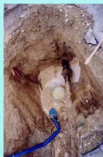
沼田西町 φ75 鋼管継手 継手離脱
