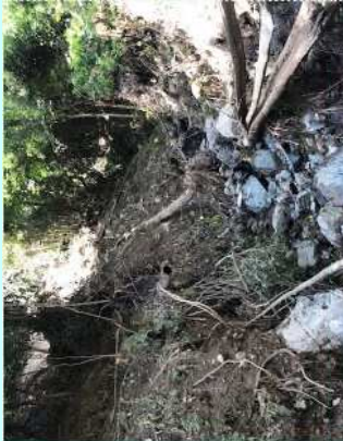
沖瀬町の配水管の被災状況
