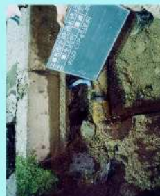
鋼管φ150 継手折れ破損 糸崎町果道糸崎港線
