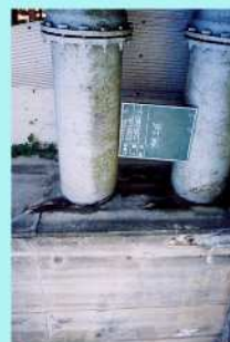
宮浦浄水場 急遽ろ過池破損（クラック）
